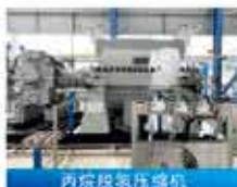
丙烷脱氢压缩机
